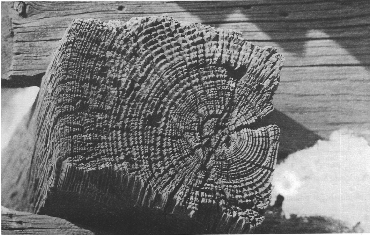
Poškození dřeva povětrností – plastická textura dřeva.
